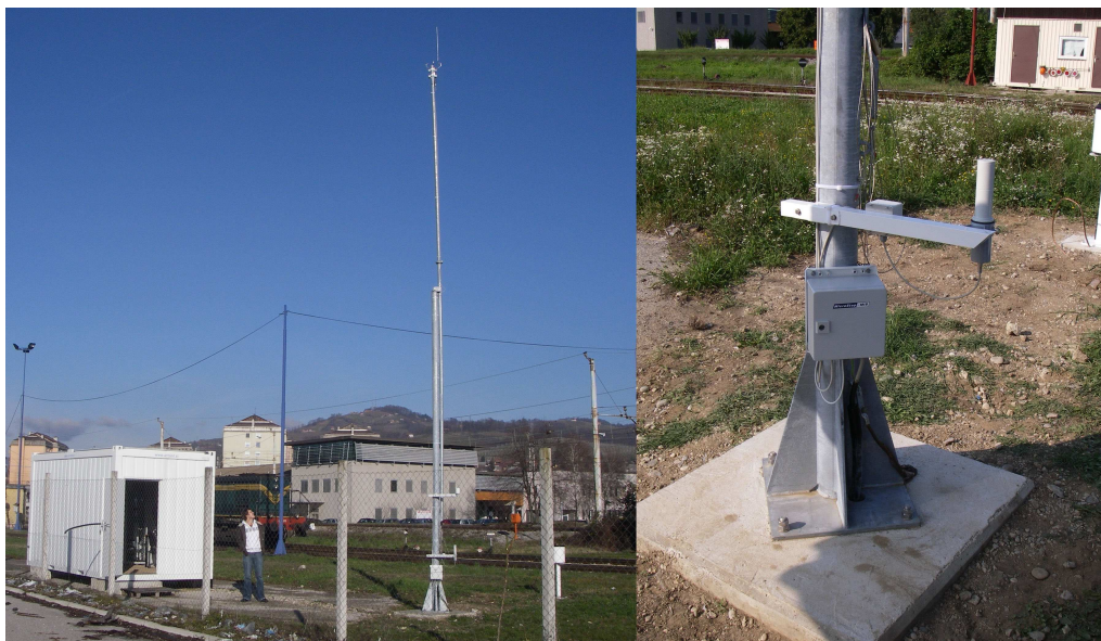
Slika 1.2 Merilno mesto v bližini NEK. Na desni je vidna sonda za merjenje hitrosti doze ionizirajočega sevanja.
