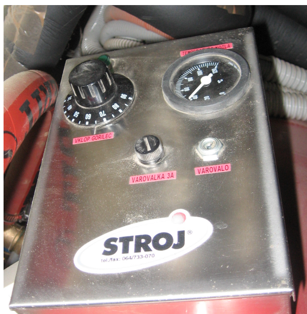
Slika 2.3: Avtomatika kotla na plinsko olje
