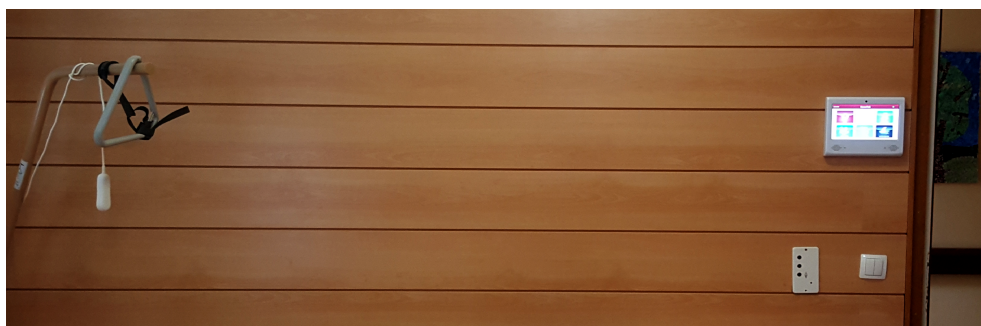
Slika 2.1: Nameščen sobni terminal v bolnišnici ter potezni gumb pri postelji.
